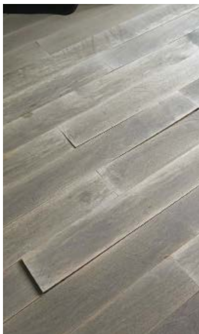
Intensive Dunkelverfärbung in den Vertiefungen der Riemen, helle Ränder oben.
