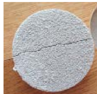
Vollflächige Mörtelschicht unten am Parkettkleber bei allen Proben / Kontrollöffnungen.
