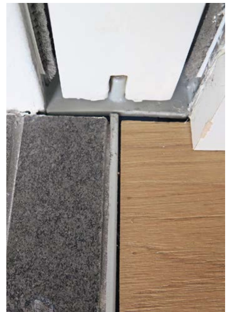
Fehlende Kittfugen bei Sichtanschlüssen.
