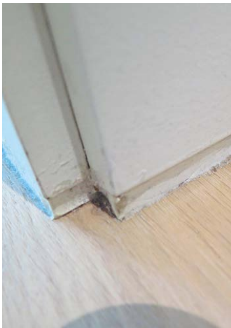
Weisse Kittfuge bei Tüorzargenfuge zum Boden hin.
