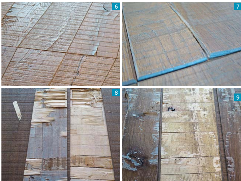
6 Aufwölbungen bei Decklagenablösungen
