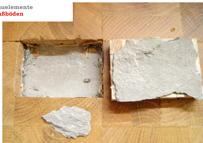
/ Hirnholzablösung über in Spackelmasse: Spackelmassen verfügen nicht über genügend Eigenfestigkeit oder werden mangelhaft eingebaut.
